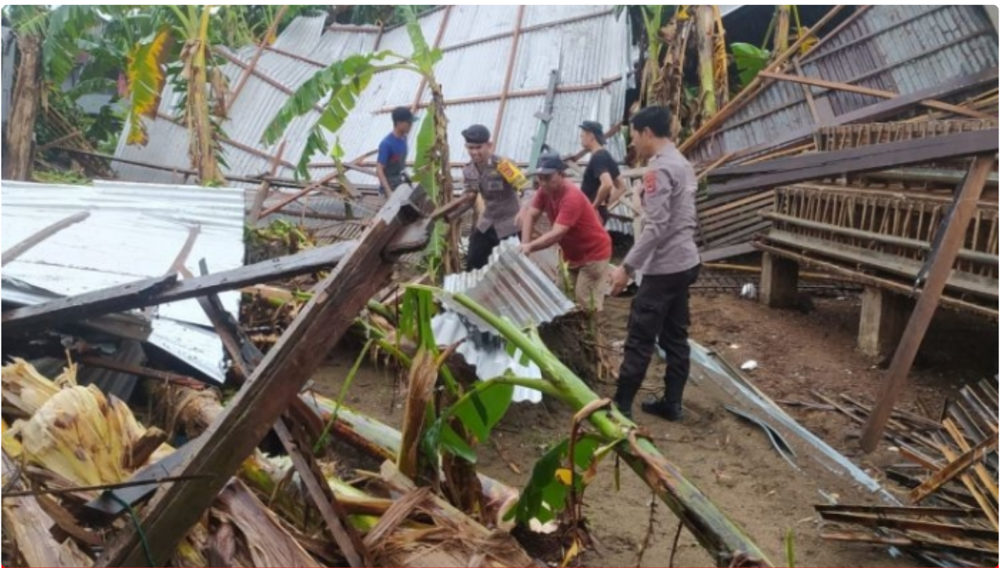
Bangunan rumah peternakan ayam milik warga Polejiwa roboh rata dengan tanah usai diterjang angin puting beliung
